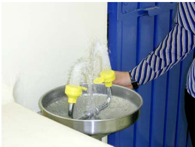
Como medida de seguridad, el Almacén cuenta con estación lavaojos.
